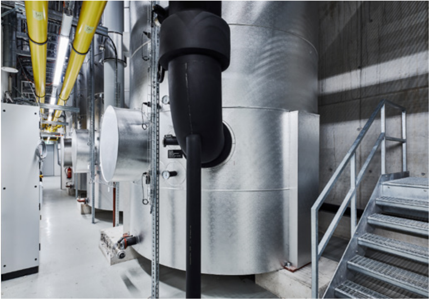
Sie bilden neben zwei Hochleistungs-Wärmepumpen den Kern der Energiezentrale: riesige Wasserspeicher für die Wärme- und Kälteaufbereitung mit einem Fassungsvermögen von je 60 Kubikmetern.
